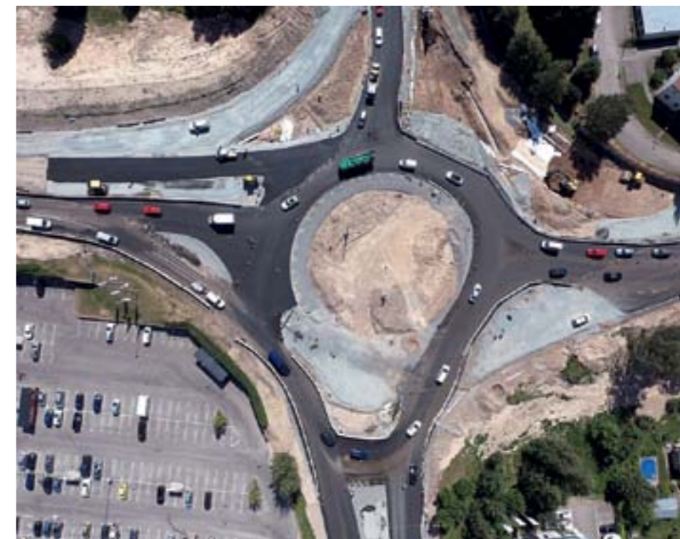
En drönbild som visar utformningen av den ombyggda Grådarondellen. Bilden togs några veckor innan slutbesiktningen den 12 oktober. Foto Trafikverket.
