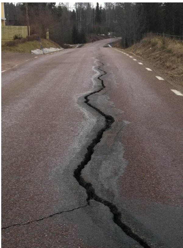
Figur 10 Tjälsprickor, här mellan trafikens hjulspår, med ohållbara lagningar. Foto: J. Granlund
