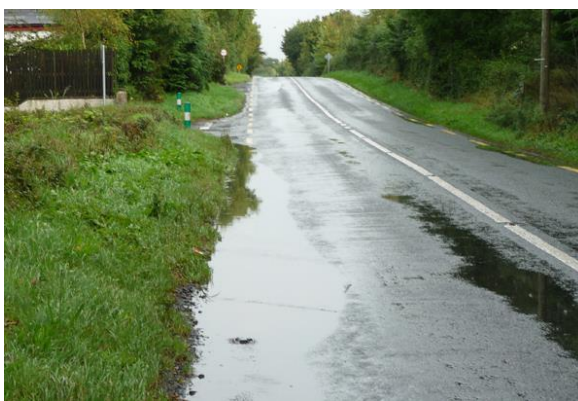
Figur 15 Dåligt avvattningsystem ger låg bärighet och förkortad väglivslängd. Bildkälla: ROADEX.
