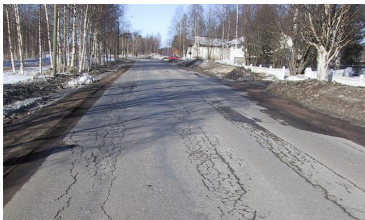
Figur 12 Trafiklastberoende sprickbildning i hjulspår på svag vägkonstruktion. Bildkälla: ROADEX.
