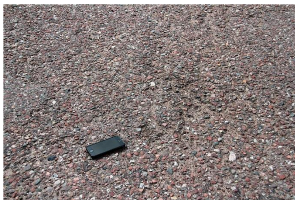
Figur 7 Stensläpp orsakat av åldrande bindemedel (oxidering). Foto: J. Granlund
