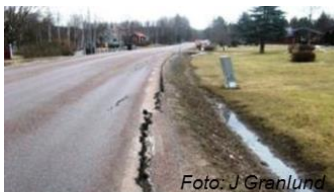
Figur 13 Vägen fick svåra kantskador sedan Trafikverket dikat bort vägkantens sidostöd
