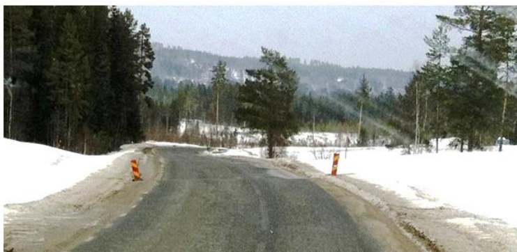
Figur 4 "Väglitage" orsakat av underdimensionerat tjältskydd. Foto: J. Granlund
